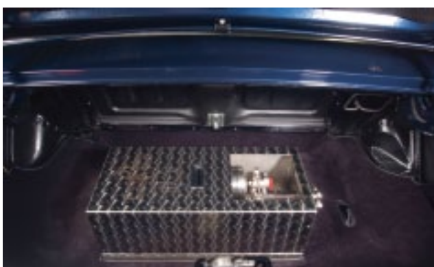
Im Kofferraum wird die Steuerung und die Löschflüssigkeit untergebracht. Hier wurde bewusst auf ein Verstecken verzichtet, da die Anlage attraktiv aussieht.
