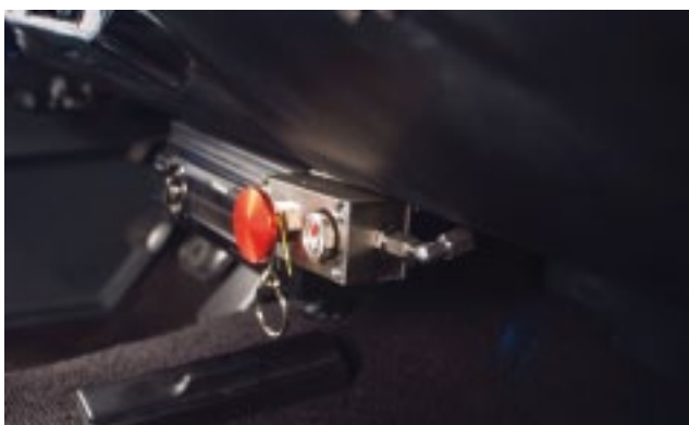
Im Innern gibt es einen zusätzlichen Schalter, der offen oder verdeckt eingebaut werden kann und über den man die Anlage auch von Hand auslösen kann.
